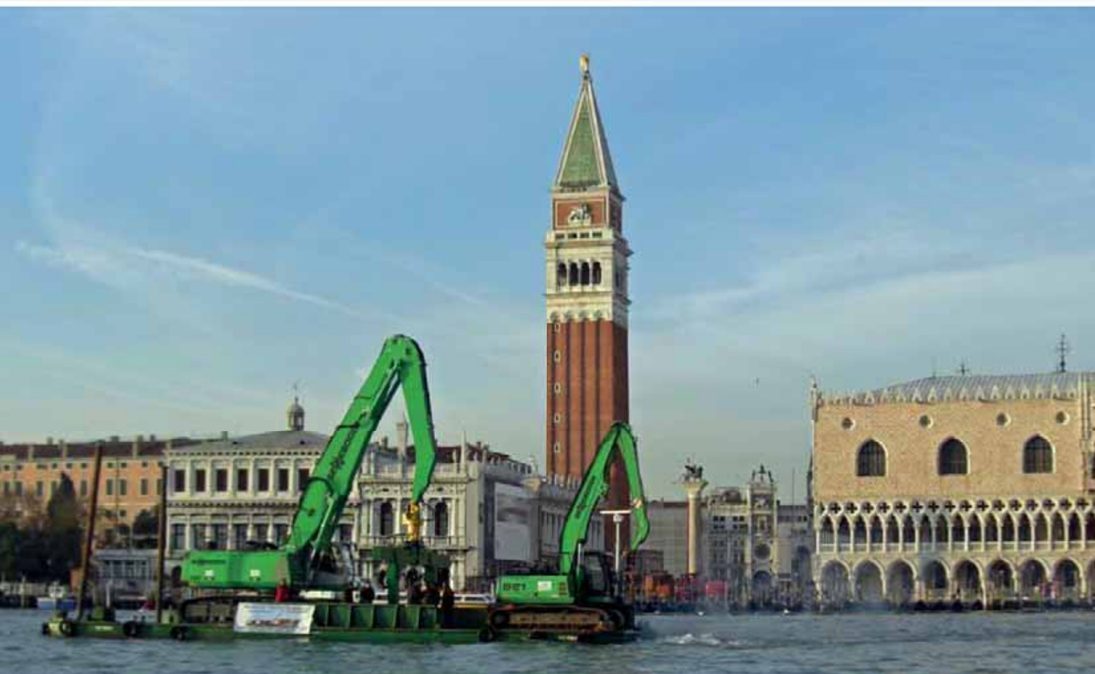
860 Crawler, 821 Crawler on pontoon - container handling of demolition waste; Venice / Italy 860 Raupe, 821 Raupe auf Ponton - Umschlag von Abbruchcontainern; Venedig / Italien
