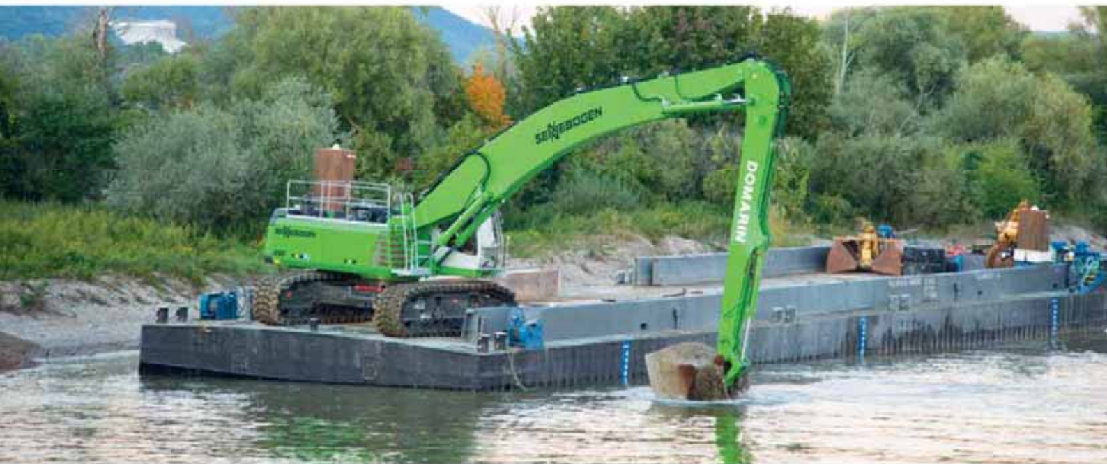
860 Crawler - dredging works on the river Danube for stream navigation; Germany 860 Raupe - Ausbaggern der Donau für die Flussschifffahrt; Deutschland
