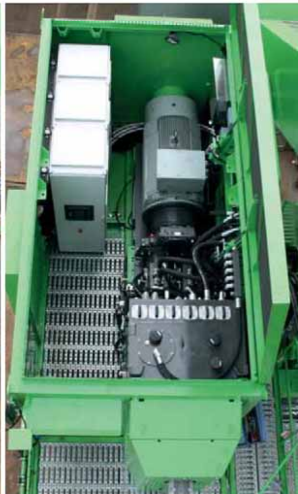
protected and service-friendly machine room geschützter und servicefreundlicher Maschinenraum
