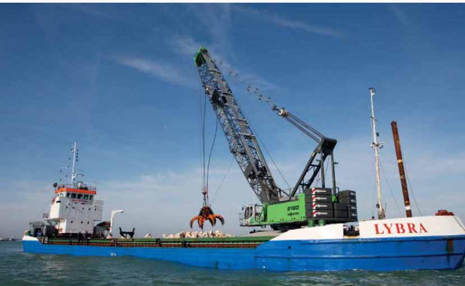
6180 HD Duty Cycle Crane - dredging- and water works on water roads; Venice / Italy 6180 HD Seilbagger - Ausbaggern und Wasserbau an Fahrwegen, Venedig / Italien
