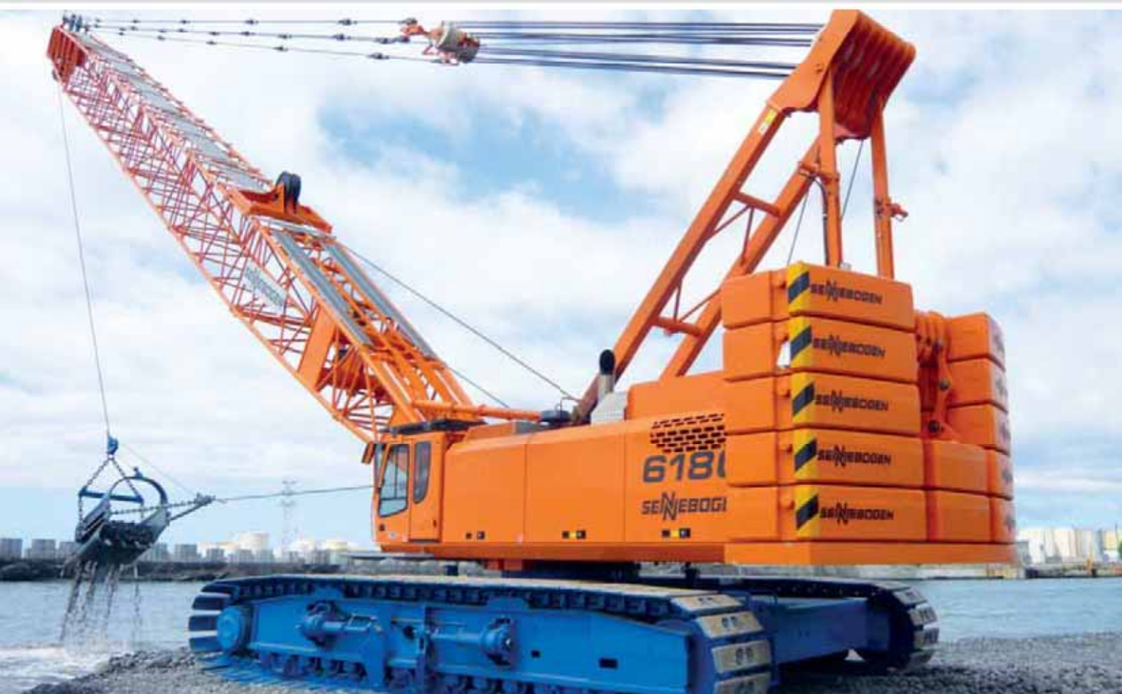
6180 HD - port maintenance and extraction from water roads with 3 m 3 dragline bucket; La Réunion 6180 HD - Hafeninstandhaltung und Ausbaggern von Wasserwegen mit 3 m 3 Schlepschaufel; La Réunion
