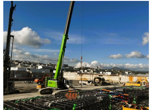
Autres visuels : manutention et mise en place des cages d'armature sur la Côte d'Azur
