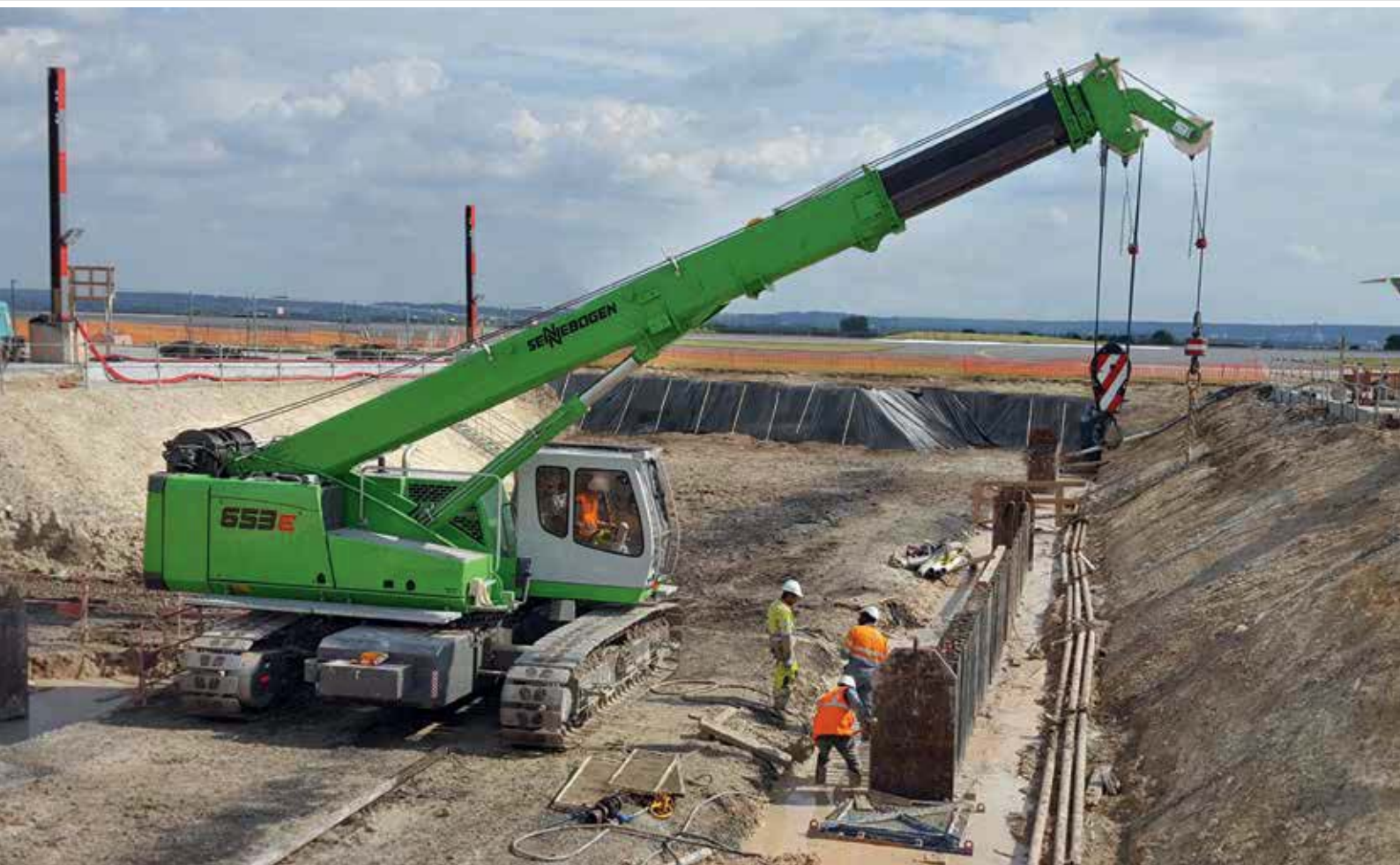
653 R - Civil and underground engineering at an airport; France 653 R - Tiefbauarbeiten auf dem Flughafengelände; Frankreich
