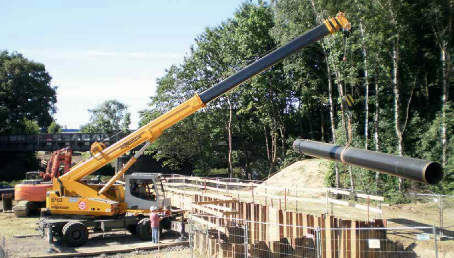
643 M - pipe installation works at civil engineerings; Germany 643 M - Rohrverlegung im Tiefbau; Deutschland
