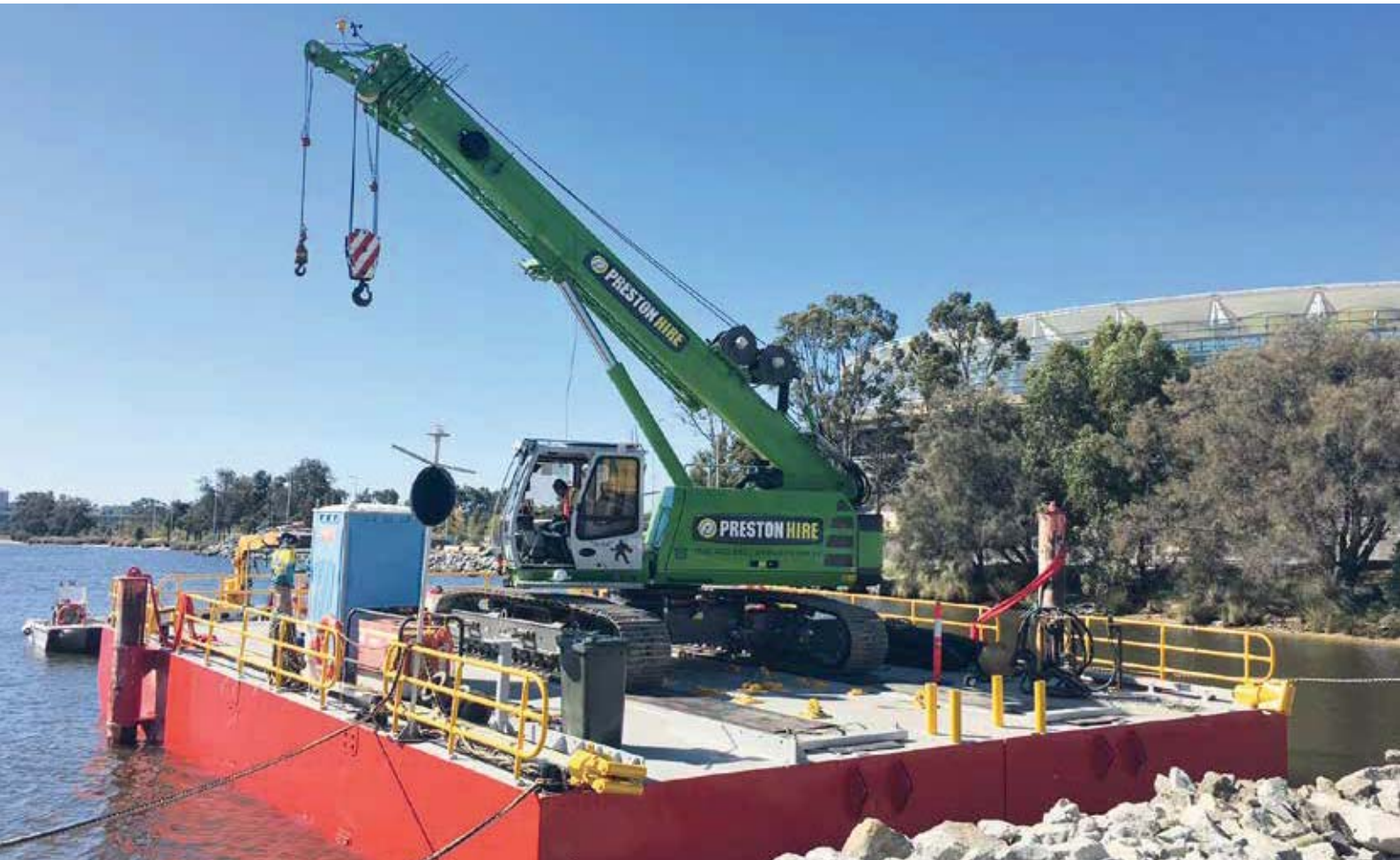
643 R - hydraulic engineering on a barge; Australia 643 R - Wasserbau auf Ponton; Australien
