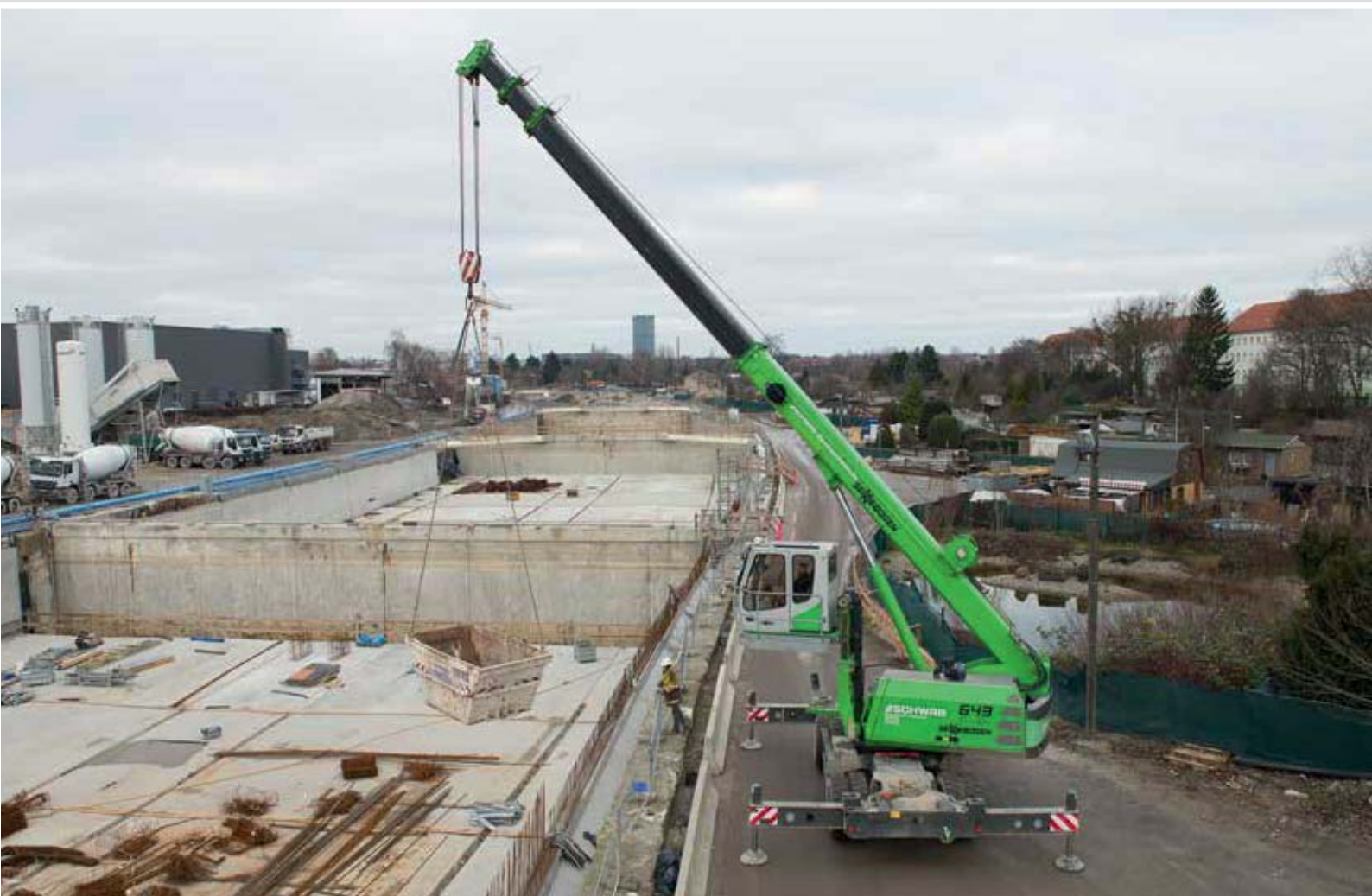
643 M - lifting tasks on construction site with vertical cab adjustment; Germany 643 M - Hebeaufgabe im Tiefbau mit vertikaler Kabinenverstellung; Deutschland
