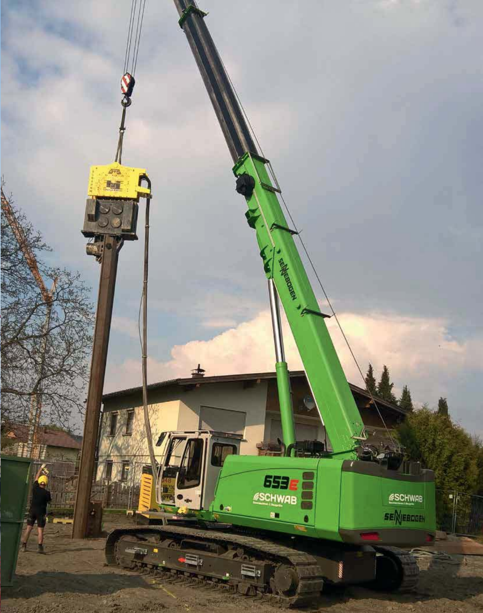
653 R - lift sheet piles safely and reliably with vibrator and bring them into the ground; Germany 653 R - mit Rüttler Spundwände sicher und zuverlässig heben und einbringen in den Boden; Deutschland
