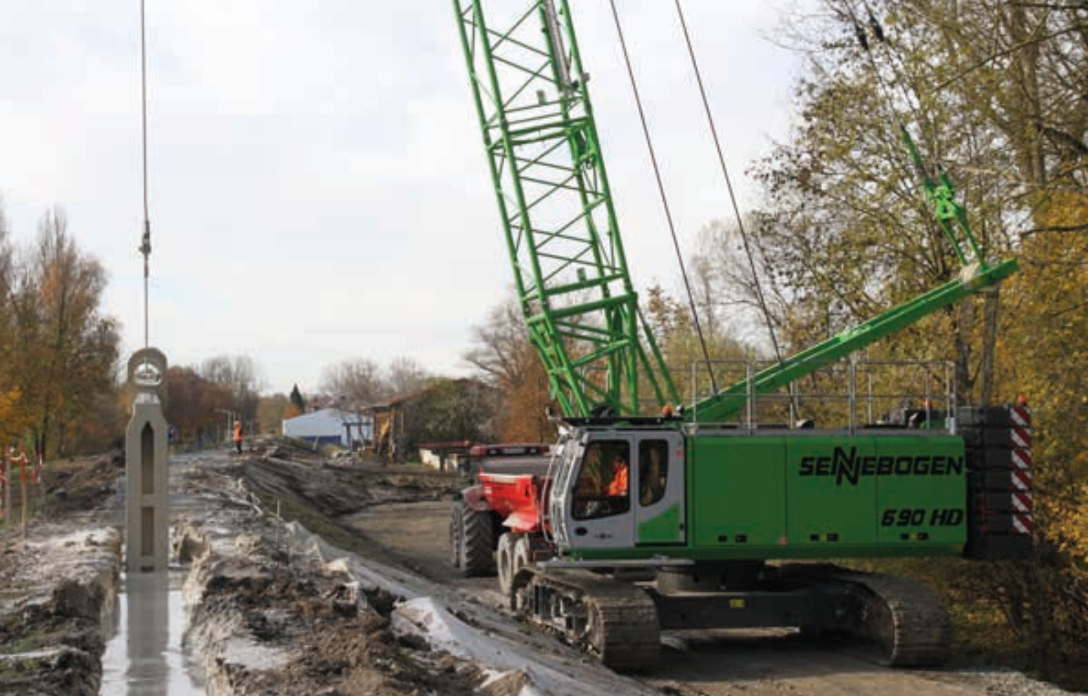
690 HD – Dike rehabilitation work with diaphragm wall grab; Germany 690 HD – Deichbefestigung mit Schlitzwandgreifer; Deutschland
