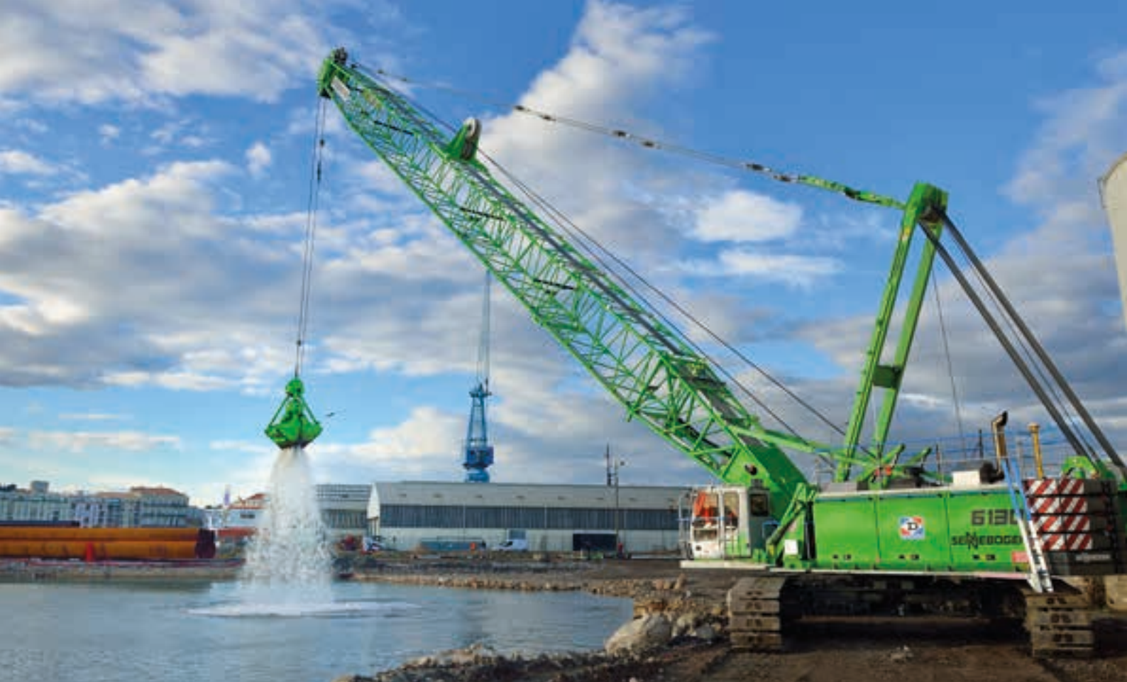
6130 HD – Grab operation in hydro construction; France 6130 HD- Greifereinsatz im Wasserbau; Frankreich
