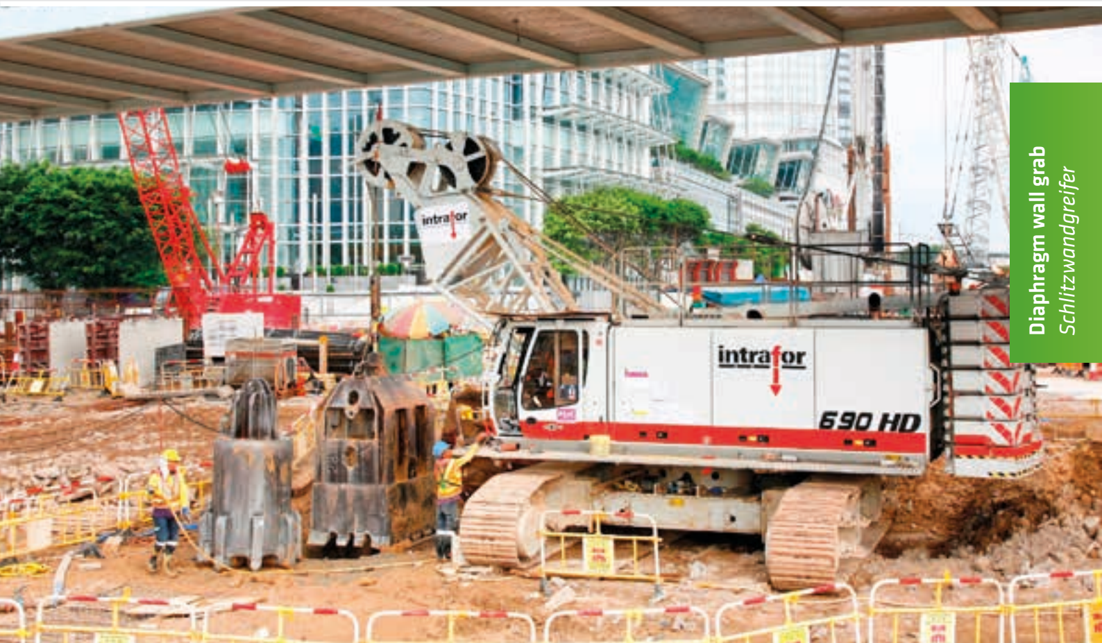
690 HD – foundation with diaphragm wall grab and low headroom boom; Hongkong 690 HD – Tiefbau mit Schlitzwandgreifer; Hongkong
